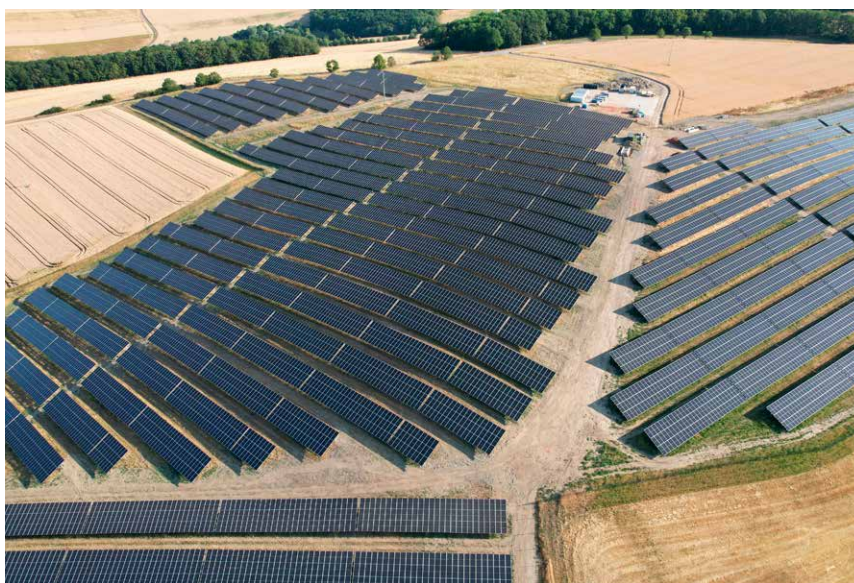
Mit dem Erwerb der Photovoltaik-Freiflächenanlage bei Niederkirchen bauen die Stadtwerke Stuttgart ihre Ökostromproduktion weiter aus.
