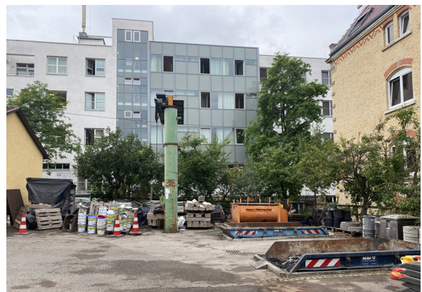
Impressionen Standort Oberrnitzstraße
