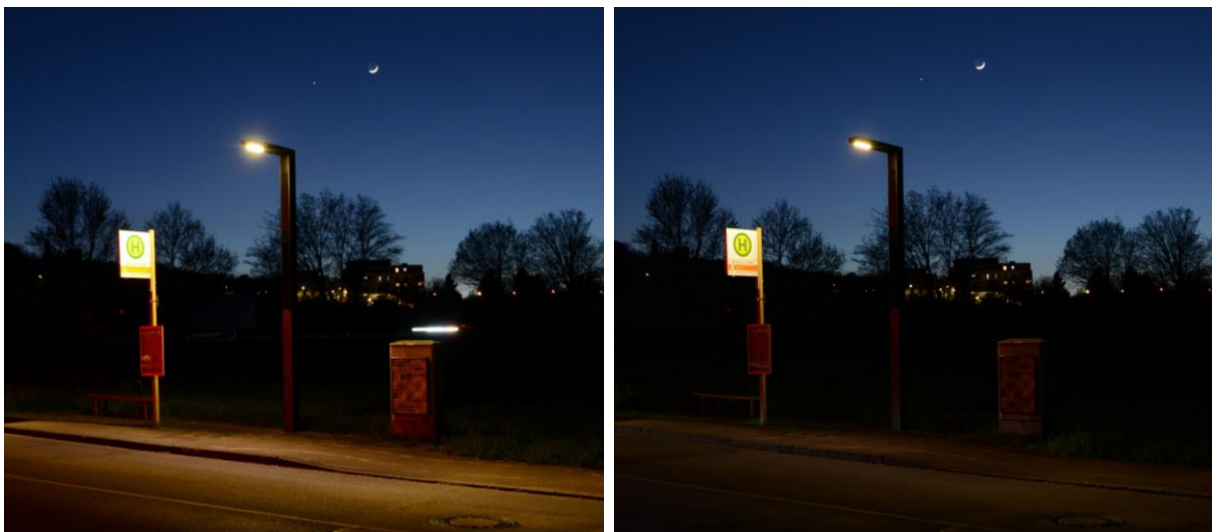
Bild 73 Solarleuchte in der Birkacher Straße, links 100% und rechts gedimmt (Quelle: Stuttgart Netze GmbH)
