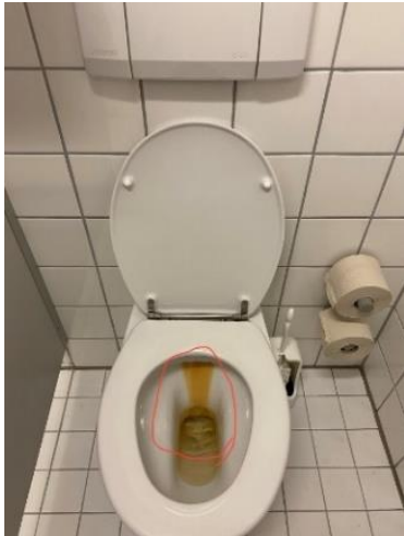
Bild 69 undichte Wasserspülung einer Toilette
