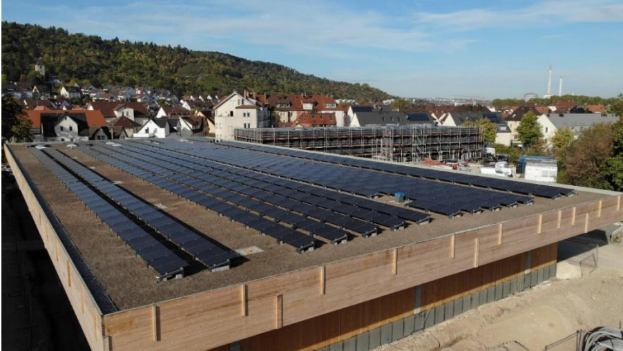
Bild 60 PV-Anlage AWS Betriebshof Gingener Str. 23 (Quelle: Amt für Umweltschutz)
