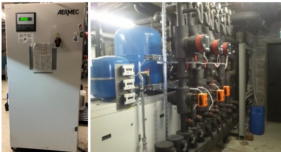
Bild 65 Kältemaschine und Kälteverteilung (Quelle: Amt für Umweltschutz)
