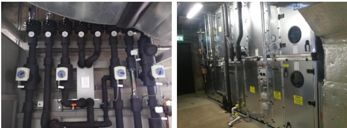
Bild 63 Wärmetauscher Wärmerückgewinnung und Lüftungsanlage (Quelle: Amt für Umweltschutz)
